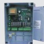
Armoire de commande
